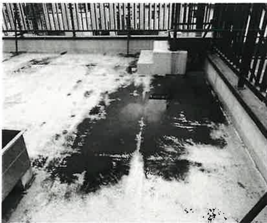
建築後30年近いビルですが、防水が切れていつ雨漏りしてもおかしくない状況でした
